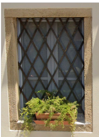
TIPOLOGIA ..... CC.03_Finestra con cornice lapiidea
